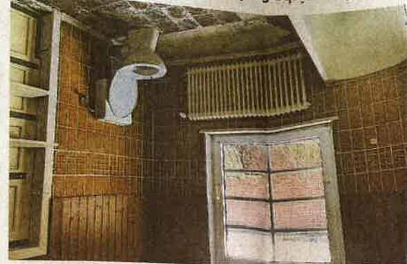
Eine umfangreiche Sanierung des Sanitärbereichs ist unumgänglich.
